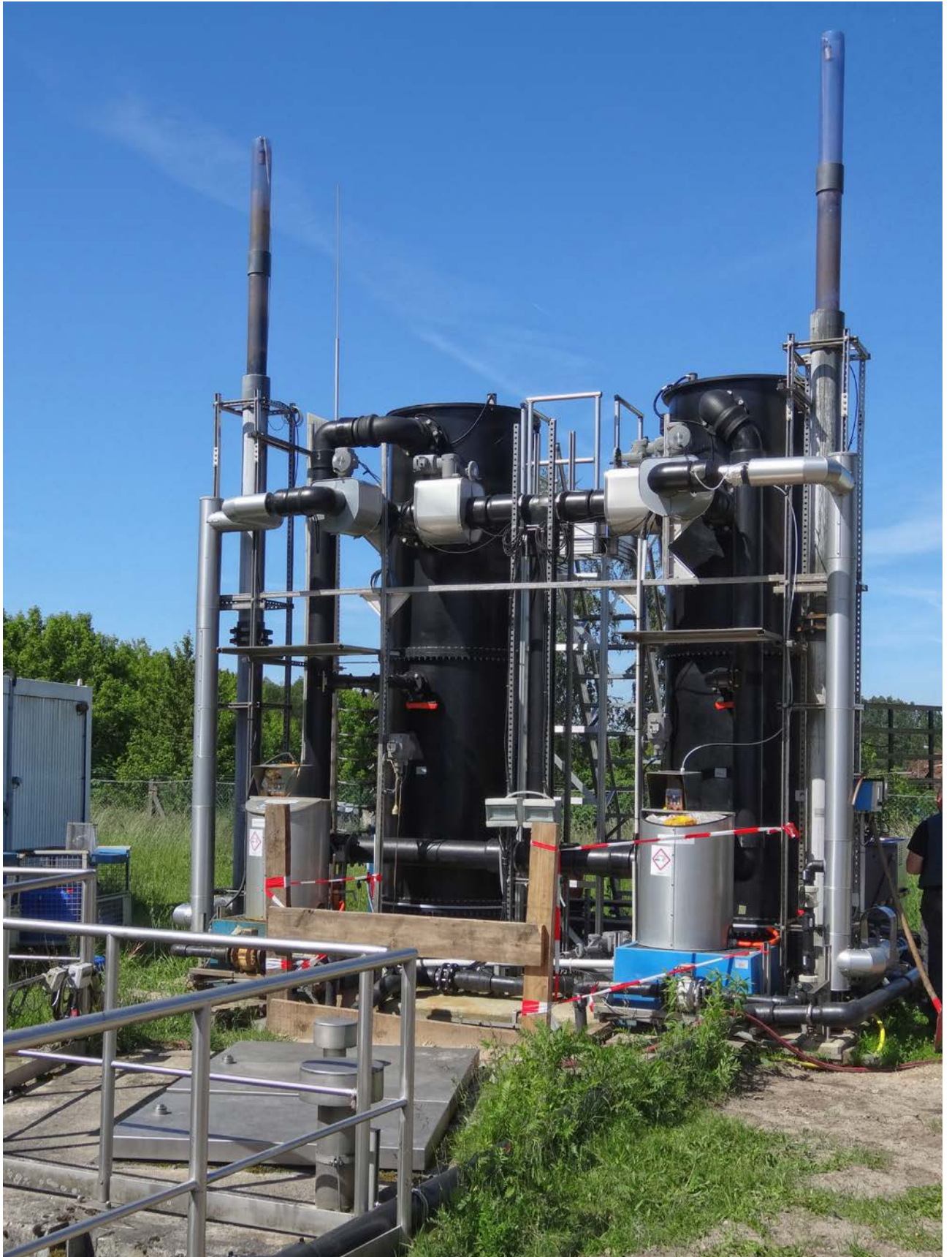
Bild 36: Ansicht der Flockungsfiltrationsanlage
